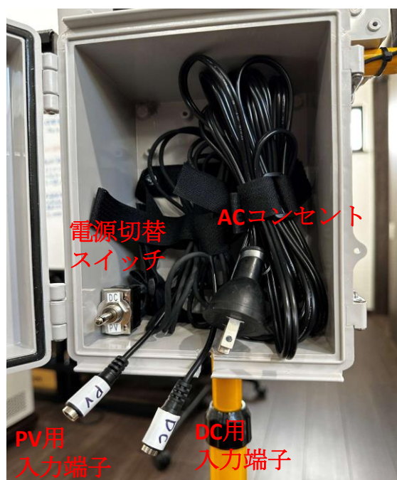
配線ボックス
